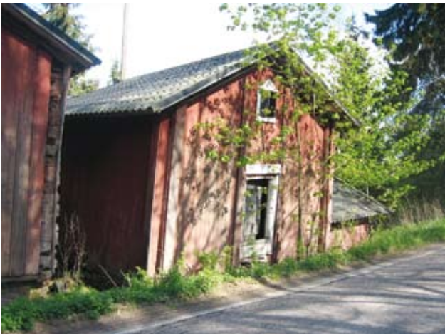
Tienpinta kohoaa ja puut hiipivät aitan kylkeen - aitta kärsii. Onneksi katto on suojattu. Hirsirakennusta on helppo korjata, jos toimeen tartutaan.
